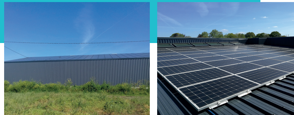
Installations photovoltaïques à Plougoulm et Clohars-Carnoët
